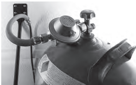
Przyłącze do reduktora na butli gazowej
