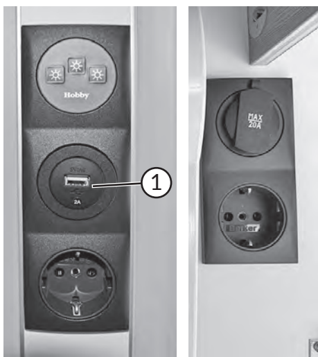
Gniazdka elektryczne wewnątrz pojazdu
