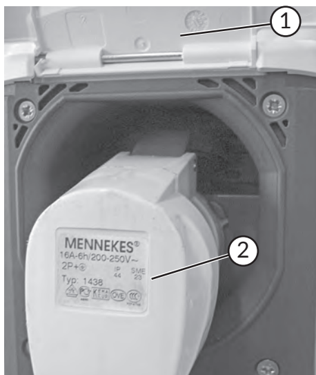
Podłączona wtyczka zasilająca 230 V
