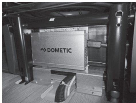
Podzespoły elektryczne pod prawym, przednim fotelem
